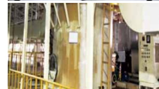
아산공장 도장 전처리 시설 집진설비 보완
