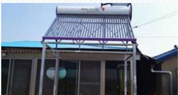
• 하드웨어 설치 (태양열)
