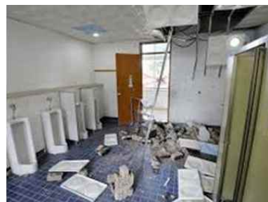
[그림 2] 화장실 천정 탈락 사례
