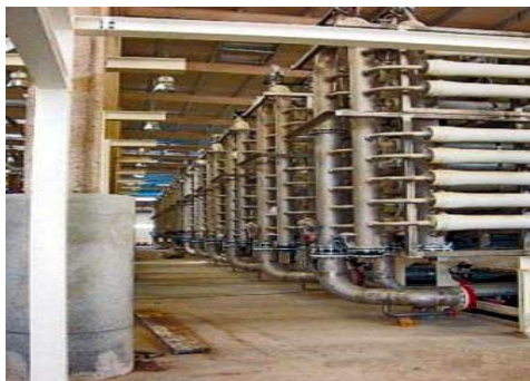
Sulaibiya RO/UF 멤브레인 물정화 시설 17)
