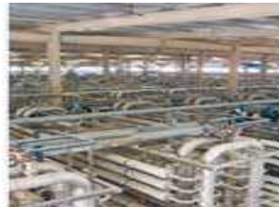
RO 시설(42개 skids 구성, 각 skid 72개 압력용기 구성, 압력용기에 7개 멤브레인 모듈 포함) 17)
